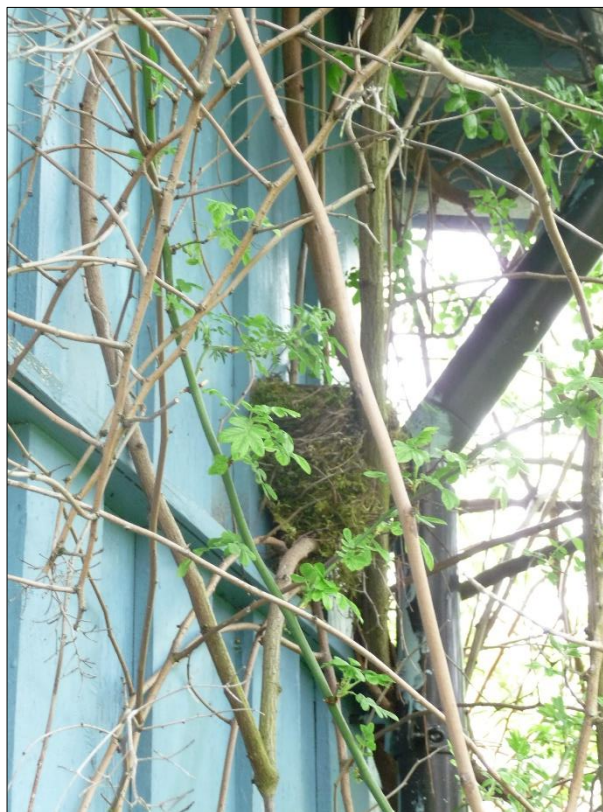
Abbildung 19: Vogelnest an der nördlichen Fassadenlängsseite des Bestandsgebäudes (Renner, 12.05.2023)
