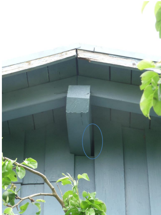
Abbildung 24. Schlupfloch mit möglichem Fledermaus - Quartierpotential an der Fassadenwestseite (Renner, 12.05.2023)
